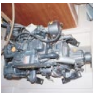
Der Maschinenraum ist mit wenigen Handgriffen frei zugänglich gemacht.
