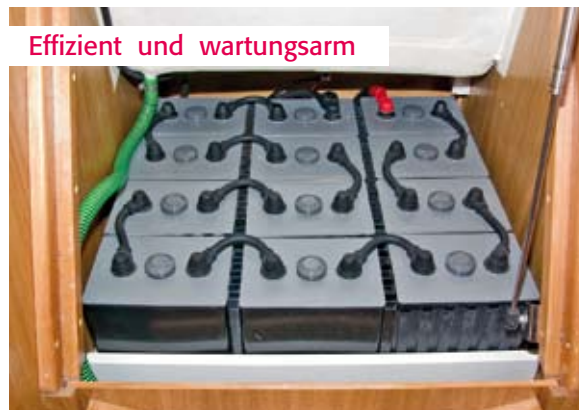
Gelbatterien statt Maschine.
