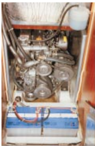
Batterien behindern den freien Zugang zur Maschine.
