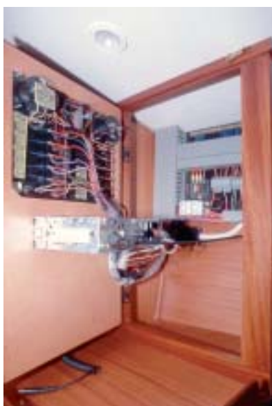
Übersichtliche Verkabelung hinter dem einfach zu öffnenden Schaltkasten
