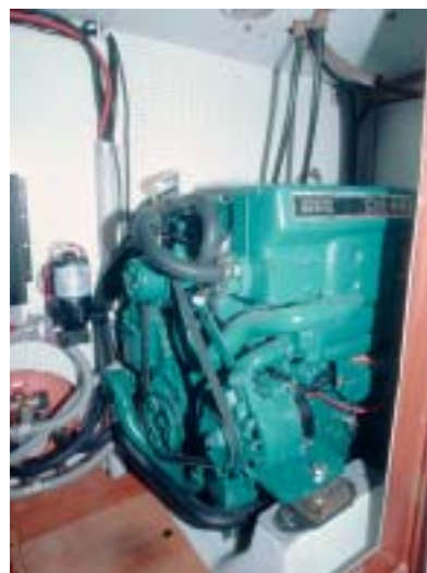
Der leistungsstarke Motor ist von der Steuerbordseite aus schwer zu erreichen
