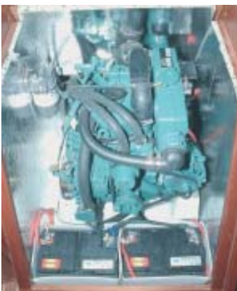
Die Batterien können im gut zugänglichen Maschinenraum zu heiß werden
