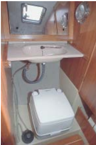
Nassraum mit Chemie WC und Waschbecken
