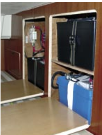
Schön gelöst: Wartungsrelevante Elemente wie Batterien und Seewasserfilter sind über Serviceluken leicht zu erreichen
