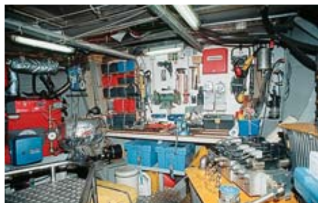
Begehbare Maschinenraum mit Werkbank und allen Pumpen und Agregaten
