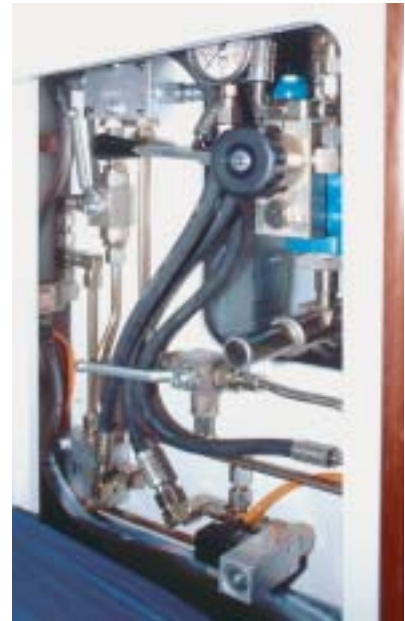
Die Hydraulik des Hubkiels ist gut zugänglich in einem Schrank installiert
